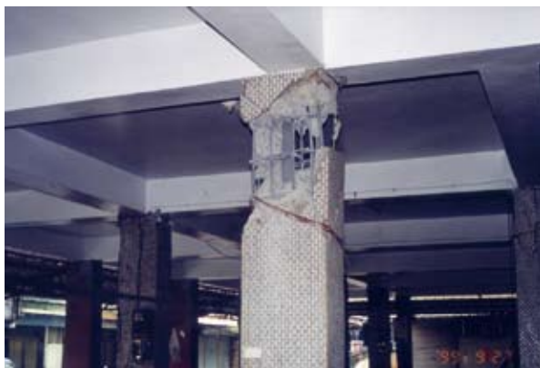
九二一地震卓蘭公有零售市場損壞情形。(曾永富提供)
