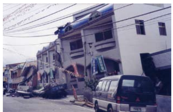
九二一地震內灣第7鄰民宅損壞情形。(曾永富提供)
