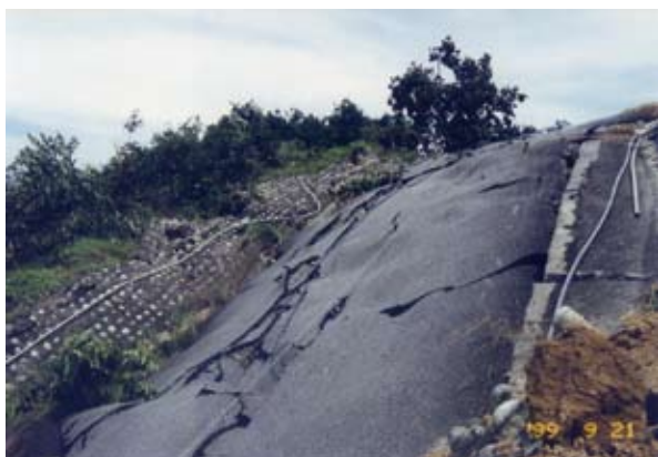
九二一地震風空農路隆起及損壞情形。(曾永富提供)
