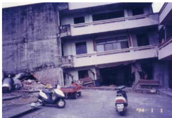
九二一地震內灣6鄰巷弄民宅損壞情形。 (曾永富提供)
