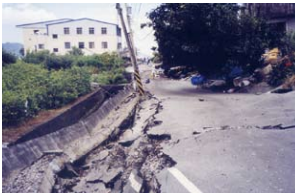
九二一地震農路損壞情形。(曾永富提供)
