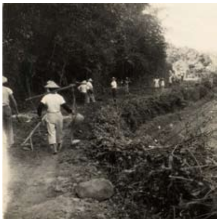
苗55線上新里食水坑道路拓寬工程以人力完成。（謝國正 曾永富提供）
