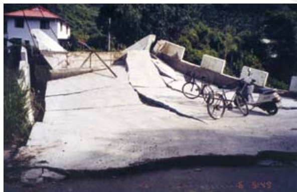
九二一地震食水坑路橋損壞情形。(曾永富提供)
