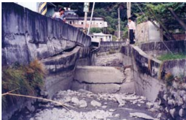
九二一地震內灣排水溝損壞情形。(曾永富提供)
