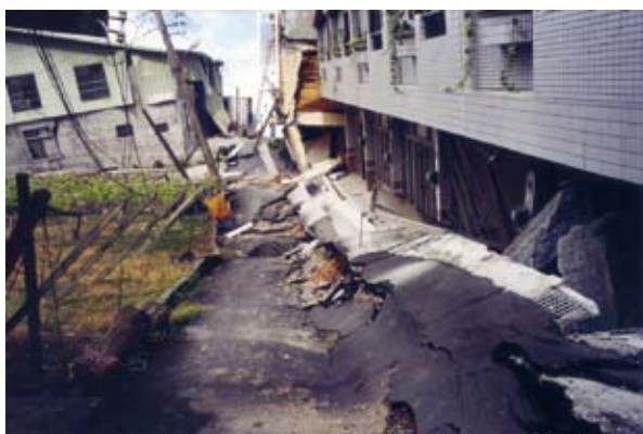
九二一地震內灣第6鄰巷弄民宅損壞情形。 (曾永富提供)
