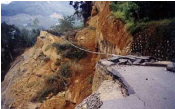
九二一地震坪林爽文農路損壞情形。(曾永富提供)
