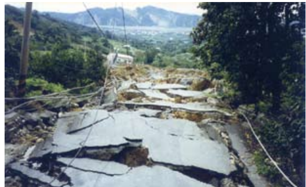
九二一地震風空農路損壞情形。(曾永富提供)
